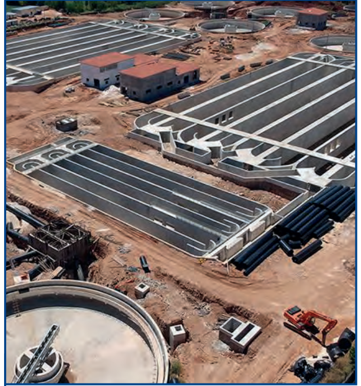
Gaziantep Çöp Suyu Arıtma Tesisi
